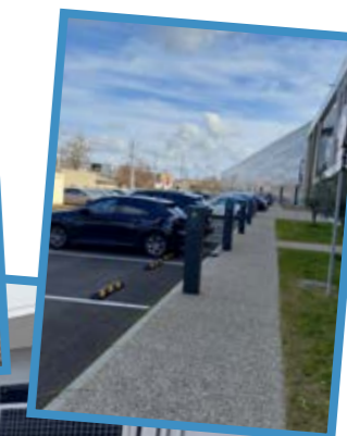
Bornes de recharge électrique pour les véhicules
